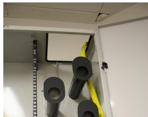
Aukko telineestä ulos lähteville kytkentäkaapeleille sekä kytkentäkaapeleiden ohjaimia.
