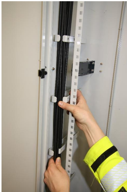
Hätäkaapeleiden sijoitus telineen vasemmalla puolen oleviin ohjainsilmukoille.
