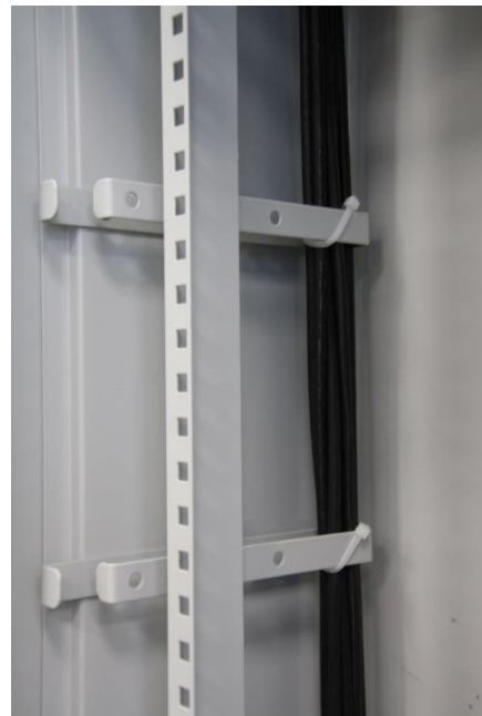
Hätäkaapelit tulee työntää ohjainsilmukoitten perälle ja kiinnittää sen jälkeen sopivina nippuina ohjainsilmukoihin, jolloin jää hyvin tilaa uusille hätäkaapeleille.
