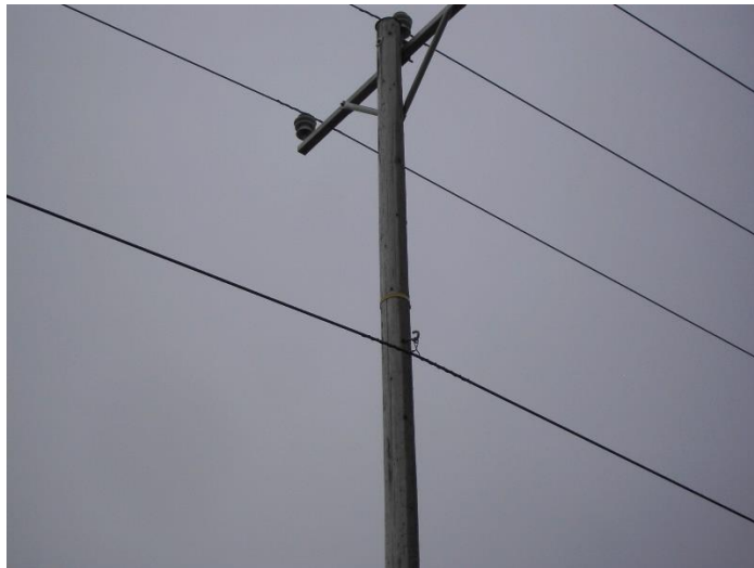
Kuva 7. ADSS-kaapeli kiinnitettynä keskijännitelinjan pylväeseen spiraalimallisella väliripustimella
