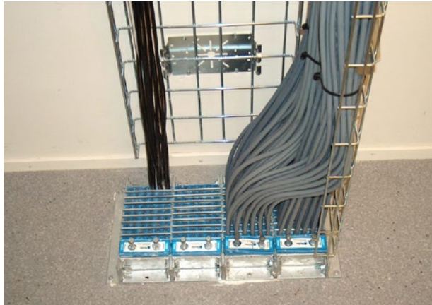
Kuva 8.22. Palokatko asettaa haasteita kaapeloinnille (Roxtec).
