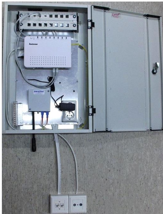
Kuva 4.25. Kotijakamon kaappi (Kuva ElmoNet Oy).
